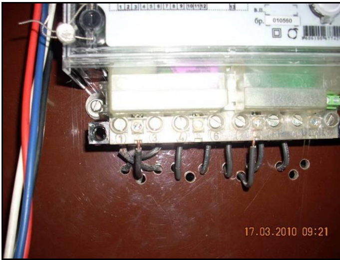
Slika 9. Neispravne strujne veze
