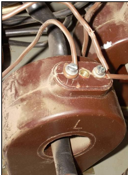
Slika 5. Neispravne strujne veze
